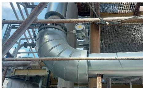
Instalação: Integração direta do sensor LiquiSonic® com flange na linha principal
